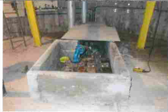
Forage protégé en tête par une margelle en béton avec capot amovible
