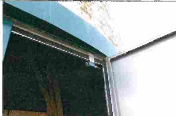
Point de détection intrusion sur la porte d'entrée de la tour
