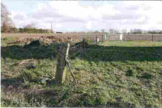
Clôture du PPI en barbelés à remplacer
